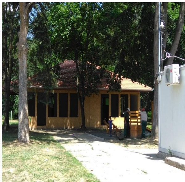
Конструкција децијег кутка уочена приликом ове посете НПМ
